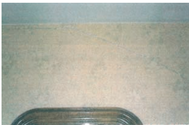
Fissuration intérieure, tapisserie déchirée - Maison André.
